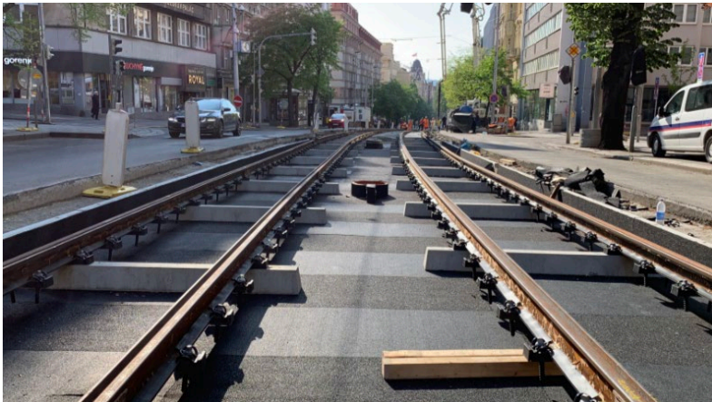
Obrázek 3: Tramvajové kolejnice NT1 (ČR), společnost Dopravní podnik hl. m. Prahy
